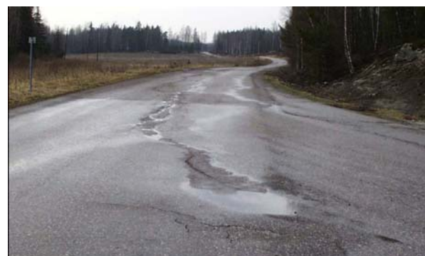
Figura 5 • exemplo de uma estrada com problemas no pavimento
